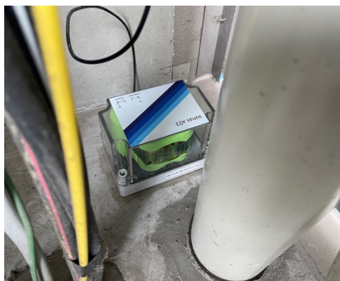
図 2：センサユニット設置の様子
